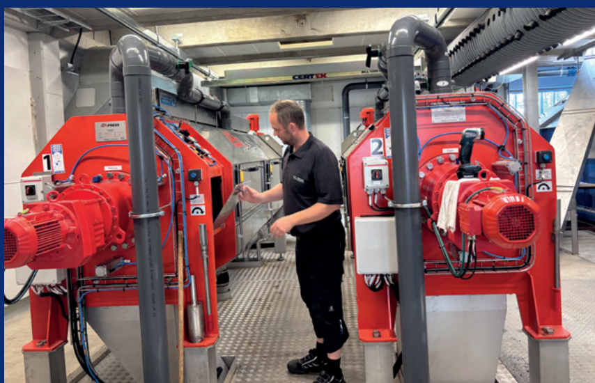
▲ Steffen har forbedret indeklimaet i slambygningen ved blandt andet at sætte ventilation op.
